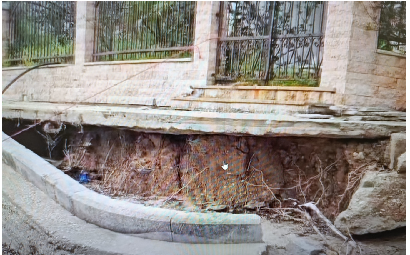
Το κράσπεδο του παραλιακού δρόμου έχει καταστραφεί από τη διάβρωση των ακτών στη Νέα Ποτίδαια
