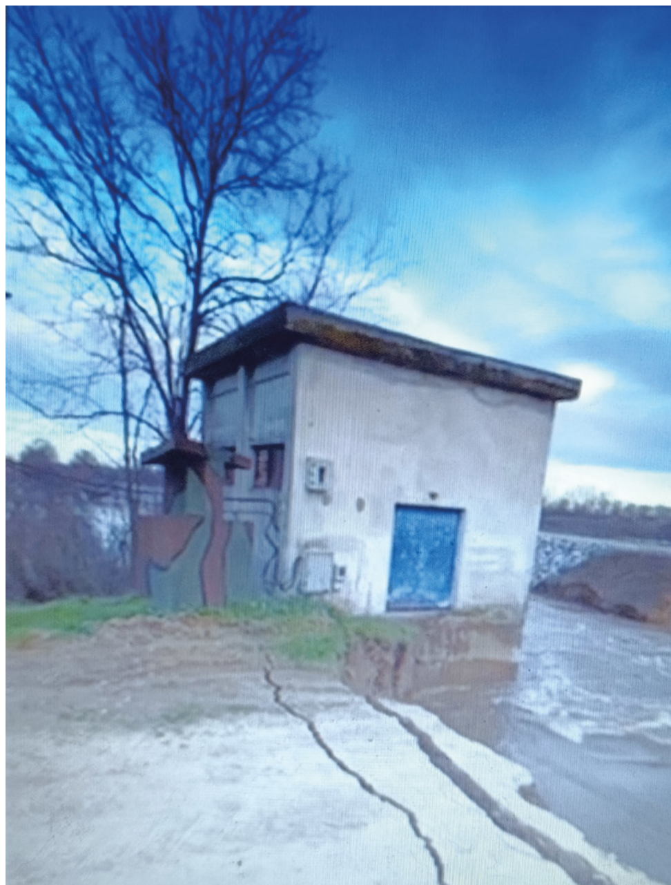
Ζημιές και σε αντλιοστάσια από τις πλημμύρες
